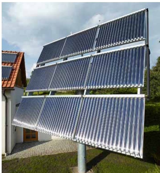
Obr. 4. Vakuové trubkové kolektory osazené na otočném stojanu sledující pohyb Slunce, referenční místo Mahring (Německo, hraniční přechod Broumov).
