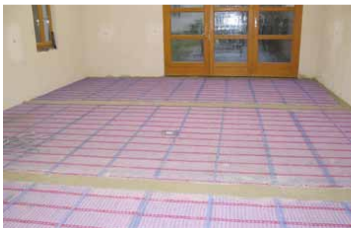
Obr. 1. Kapilární rohože na podlahové konstrukci před zakrytím betonovou stěrkou a finální povrchovou úpravou
