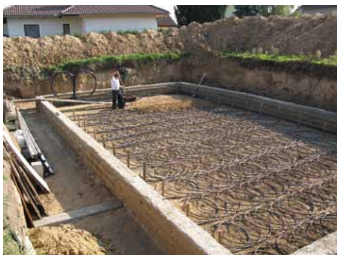
Obr. 6. Zemní akumulátor, zdroj nízkopotenciální energie pro tepelné čerpadlo, zdroj chladu pro letní režim pasivního chlazení; slinky horizontal 2x 14 x 70 mb PE DN16 experimentální kolektor situovaný ve 2 vrstvách pod podkladní deskou objektu
